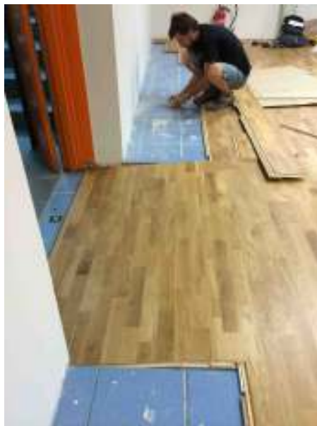
Détail pente PMR sur mesure sur Attivita chêne (Ecole de Rochelle Adams)
